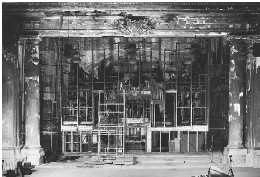
Estrada widok ogólny – stan po pożarze. Archiwum autora
